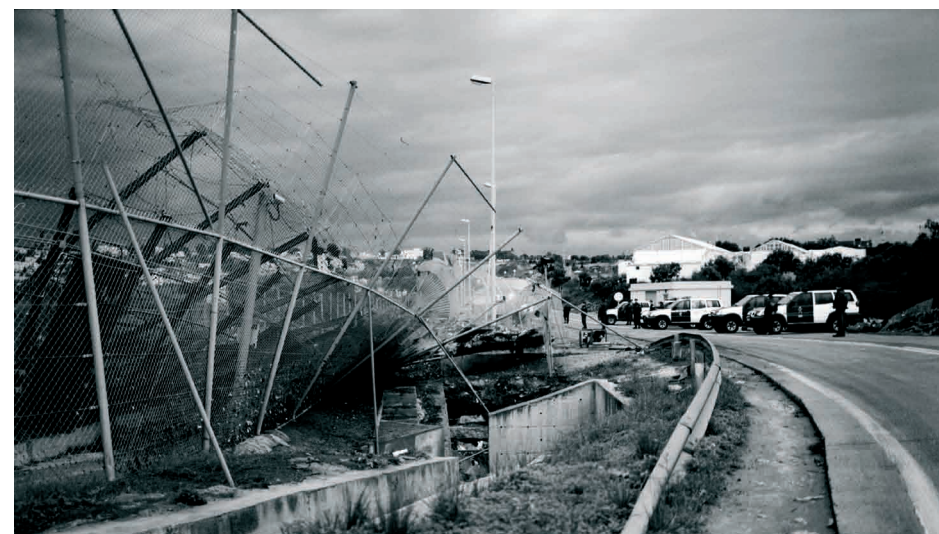
La valla – en novembre 2008, les fortes pluies font céder les fondations de la barrière. Melilla, Espagne, 2008
